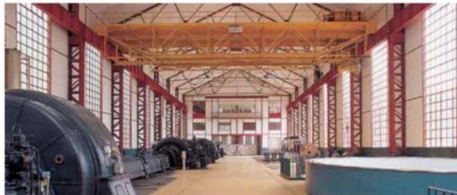
La centrale idroelettrica di Edison a Teglia di Pontremoli
